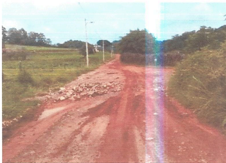
Bairro São João – um dia após a chuva
