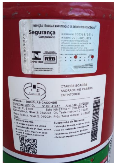
Figura 1 – Data de validade do extintor e data para a próxima vistoria 04/2024.
