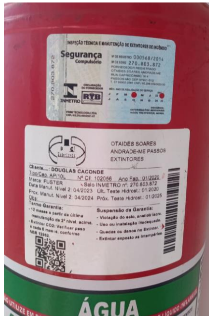
Figura 2 – Data de validade do extintor e data para a próxima vistoria 04/2024.
